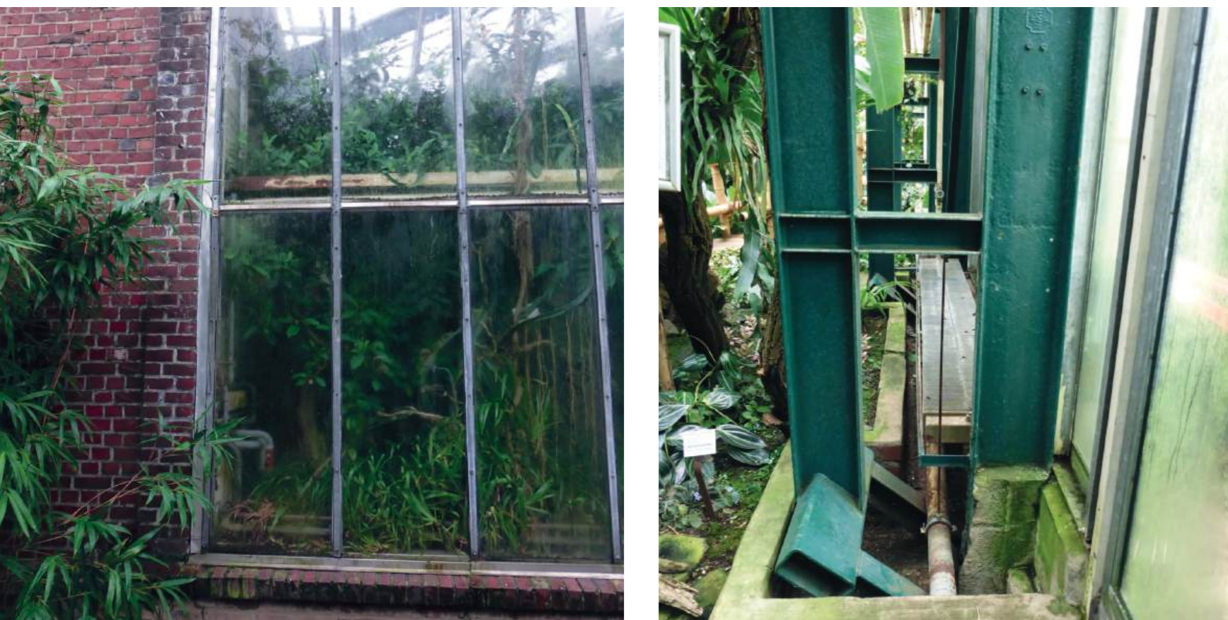
Einfachverglasung als „Energieschleuder“, 2013 Statische Ertüchtigung der korrodierten Stahlstützen, 2013 Marode Technik, 2013
